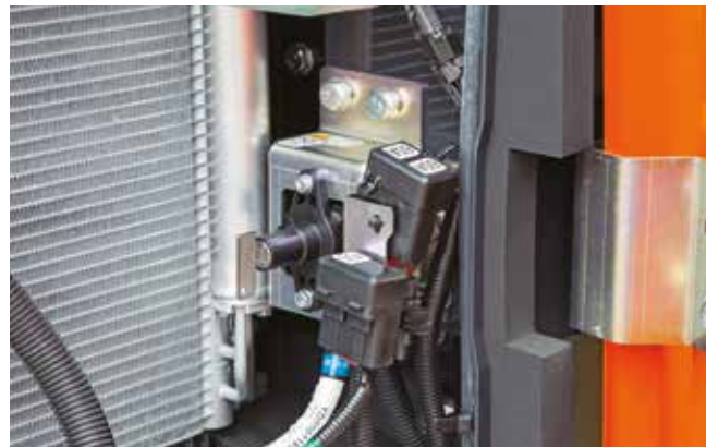
Wyłącznik akumulatora umożliwia bezpieczne wykonywanie konserwacji.
